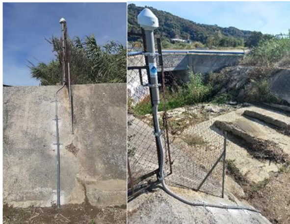
Figure 3 - Sonde piézométrique installée sur le vallon de l'Enghieri à Gattières
